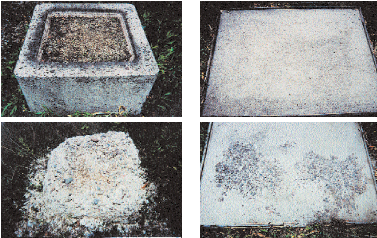
Fig. 8-3. Efecto del envejecimiento en cajas y losas sobre el terreno en una investigación de larga duración en ambiente externo, proyecto 10, PCA, Skokie, Illinois. Los especímenes de arriba se produjeron con 335 kg (564 lb) de cemento ASTM tipo I por metro cúbico (yarda cúbica). Periódicamente, se aplicó, sobre las losas, el descongelante de cloruro de calcio. Las fotos muestran especímenes con 40 años de edad (véase Klieger 1963 para información sobre la mezcla de concreto). (IMG12408, IMG12406, IMG12407, IMG12405)
