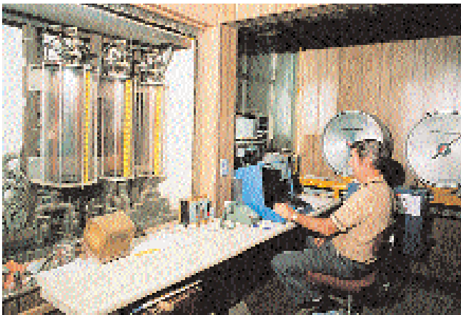
Fig. 6-20. El dosificador de aditivo líquido en una planta de concreto premezclado da una medida volumétrica precisa de los aditivos. (IMG12323)
