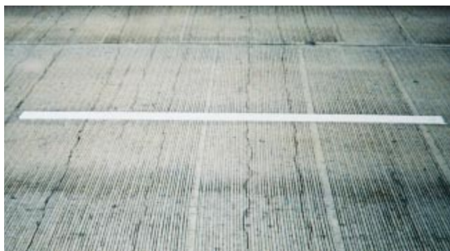
Fig. 6-17. Fisuras por contracción, tales como las enseñadas en este tablero de puente, se pueden reducir con prácticas adecuadas de colocación, acabado y curado de concreto y con el uso de aditivos reductores de contracción. (IMG12418)
