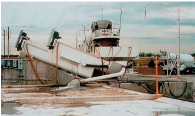
Fig. 4-4. Los sistemas de recuperación permiten el uso inmediato del agua de lavado en el mezcla. (IMG12425)
