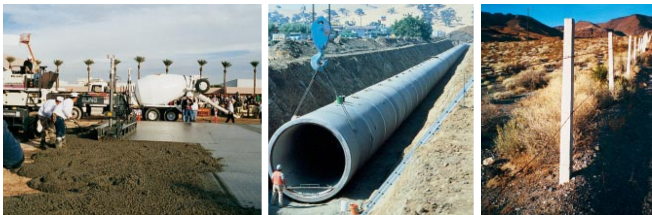
Fig. 2-14. Los cementos de moderada resistencia a los sulfatos y alta resistencia a los sulfatos mejoran la resistencia a los sulfatos de los miembros de concreto, tales como (de la izquierda a la derecha) losas sobre el suelo, tubería y postes de concreto expuestos a suelos con alto contenido de sulfatos. (IMG12484, IMG12483, IMG12482)
